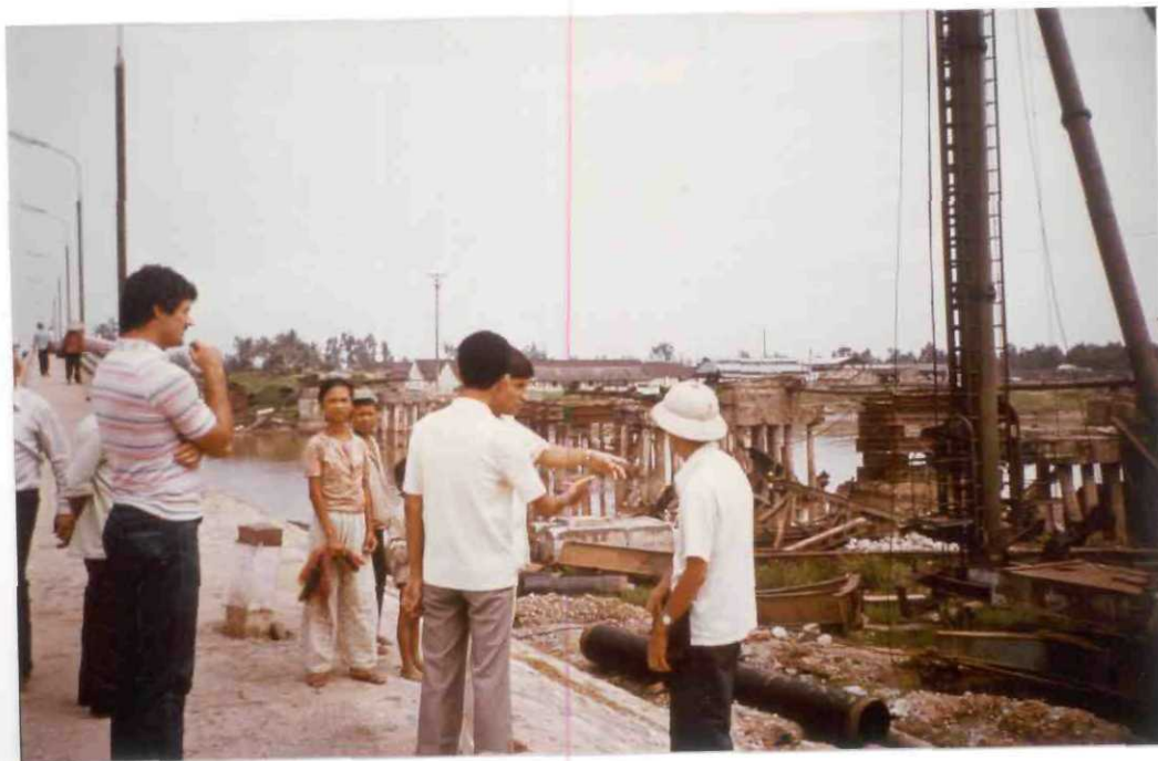
APRES DESTRUCTION D'UN PONT (p30)
